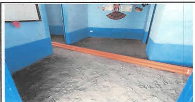
Foto 6: Piso de direccion levantado que estaba dañado.
