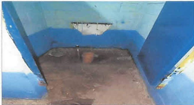
Foto1: Baño para niñas: piso levantado y drenaje destapado de las raíces de arboles.
