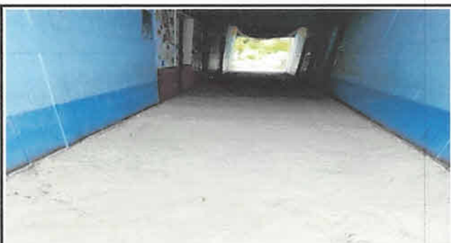
Foto 4: Piso del pasillo levantado y raíces desenteradas.
